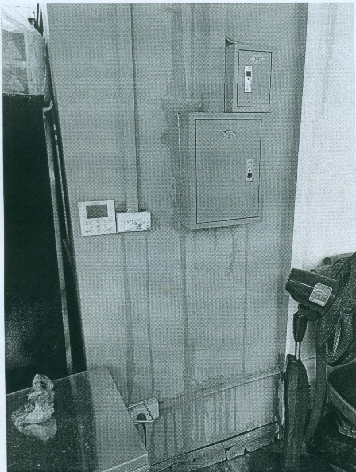
Ảnh 5. Hiện trạng khu vực đặt tủ điện, ổ cắm và thiết bị điện: tường có các vết nước thấm chảy theo phương đứng, cần ưu tiên kiểm tra, xử lý.
