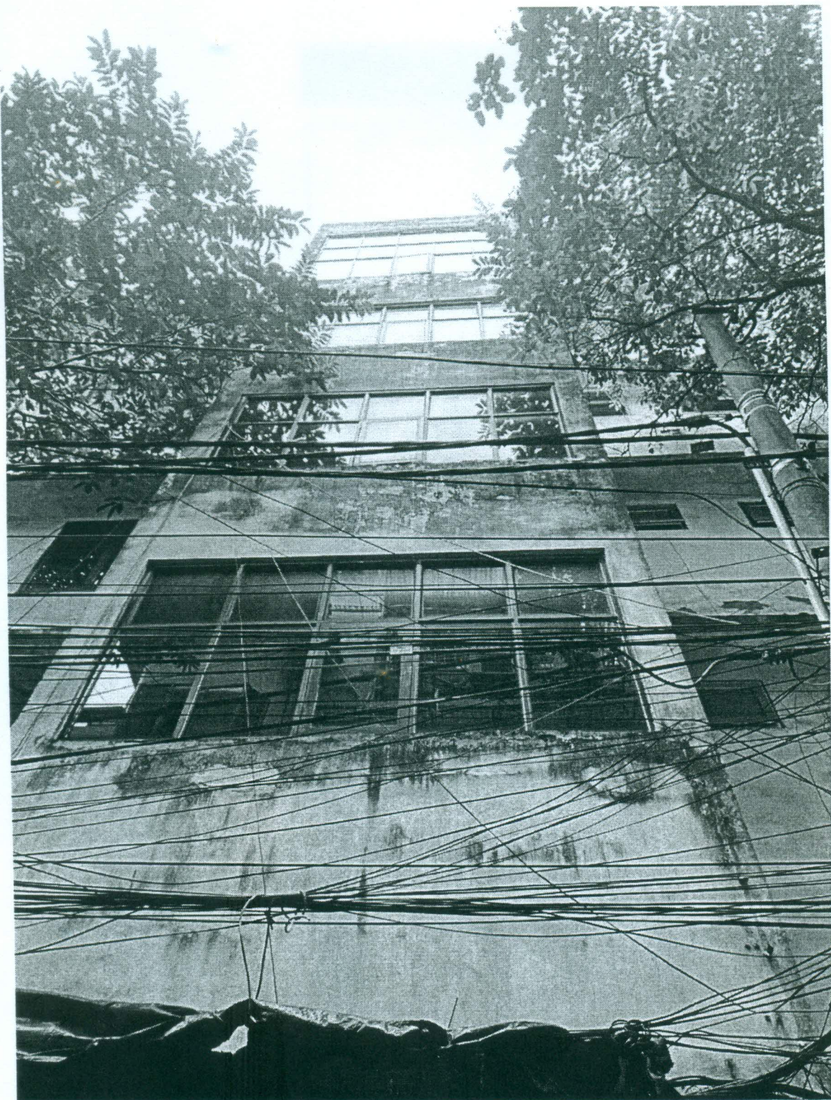
Ảnh 2. Hiện trạng mặt sau tòa nhà: bề mặt tường xuống cấp, thấm ẩm kéo dài, xuất hiện nhiều mảng loang lổ, rêu mốc và bong tróc lớp sơn.
