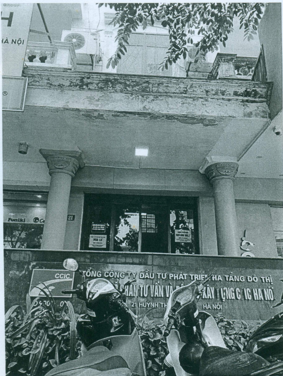
Ảnh 8. Hiện trạng mặt tiền và sảnh phía trước: khu vực mái/sảnh có dấu hiệu thấm ẩm, bong tróc và xuống cấp lớp sơn hoàn thiện.
