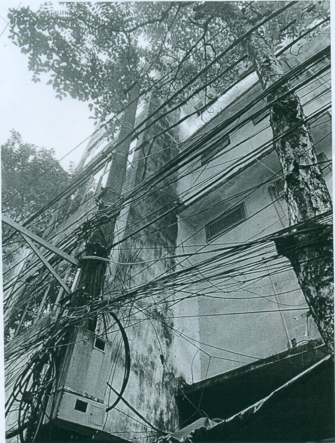
Ảnh 1. Hiện trạng mặt bên/mặt sau tòa nhà: tường ngoài ẩm mốc, loang ố, bong tróc; hệ thống dây cáp kỹ thuật nổi dày đặc, ảnh hưởng mỹ quan.
