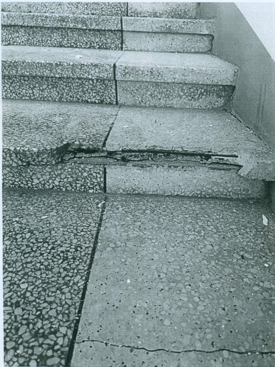
Ảnh 7. Hiện trạng bậc cầu thang: một số bậc nứt, vỡ, sứt mẻ phần mũi bậc và bong tách lớp hoàn thiện.
