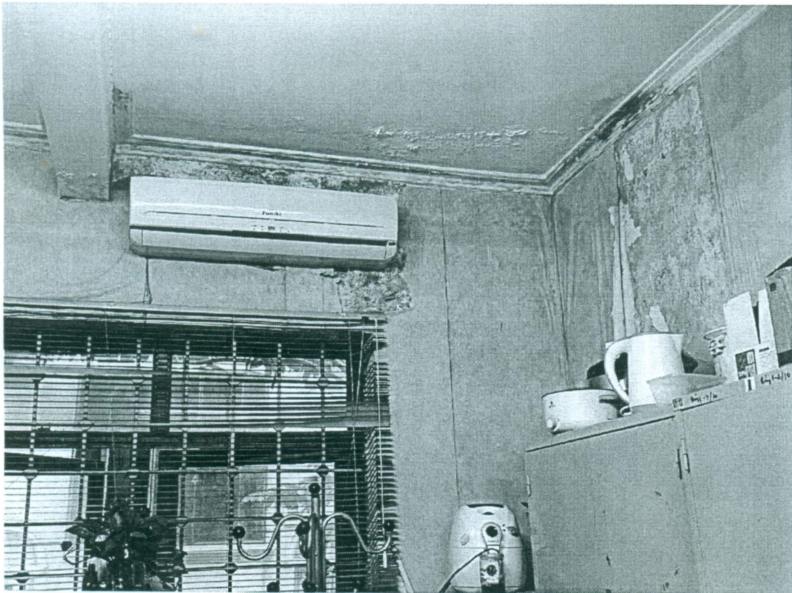
Ảnh 4. Hiện trạng phòng làm việc tầng 2: tường và trần bị thấm ẩm, bong tróc, sùi lớp hoàn thiện và xuất hiện nấm mốc.
